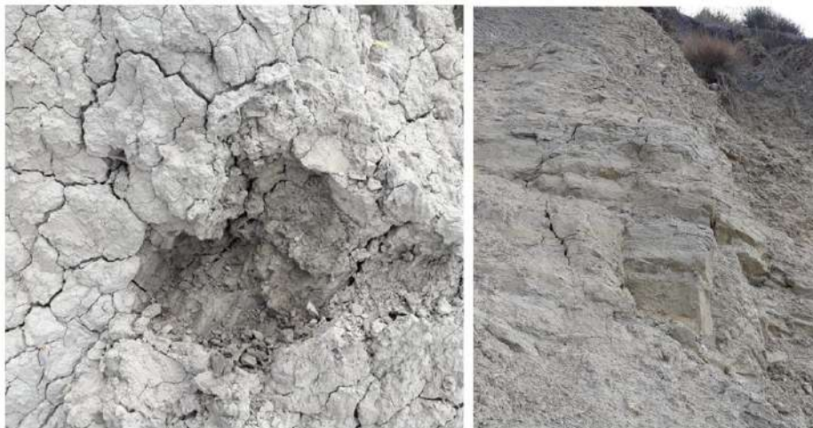
Figura 3.2: Paraqitje e gjendjes së argjilave in-situ: (majtas) edhe pse e thatë në sipërfaqe, në brendësi përmban ujë; (djathtas) zhvillimi i sistemit të çarjeve në faqen vertikale të shpatit
