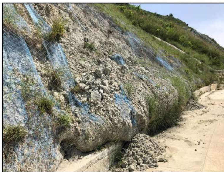
Figura 5.6: Deformimet dhe çarjet që kanë pëzuar rrjetat mbajtëse për shkak të shkrifërimit të argjilës
